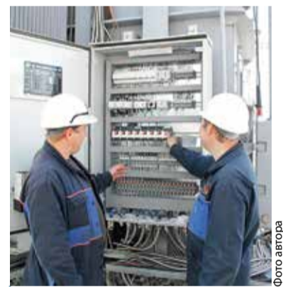
Инженер группы релейной защиты Михаил Носулин и начальник участка ГПП-2 Сергей Предеин у шкафа управления обдувом трансформатора
